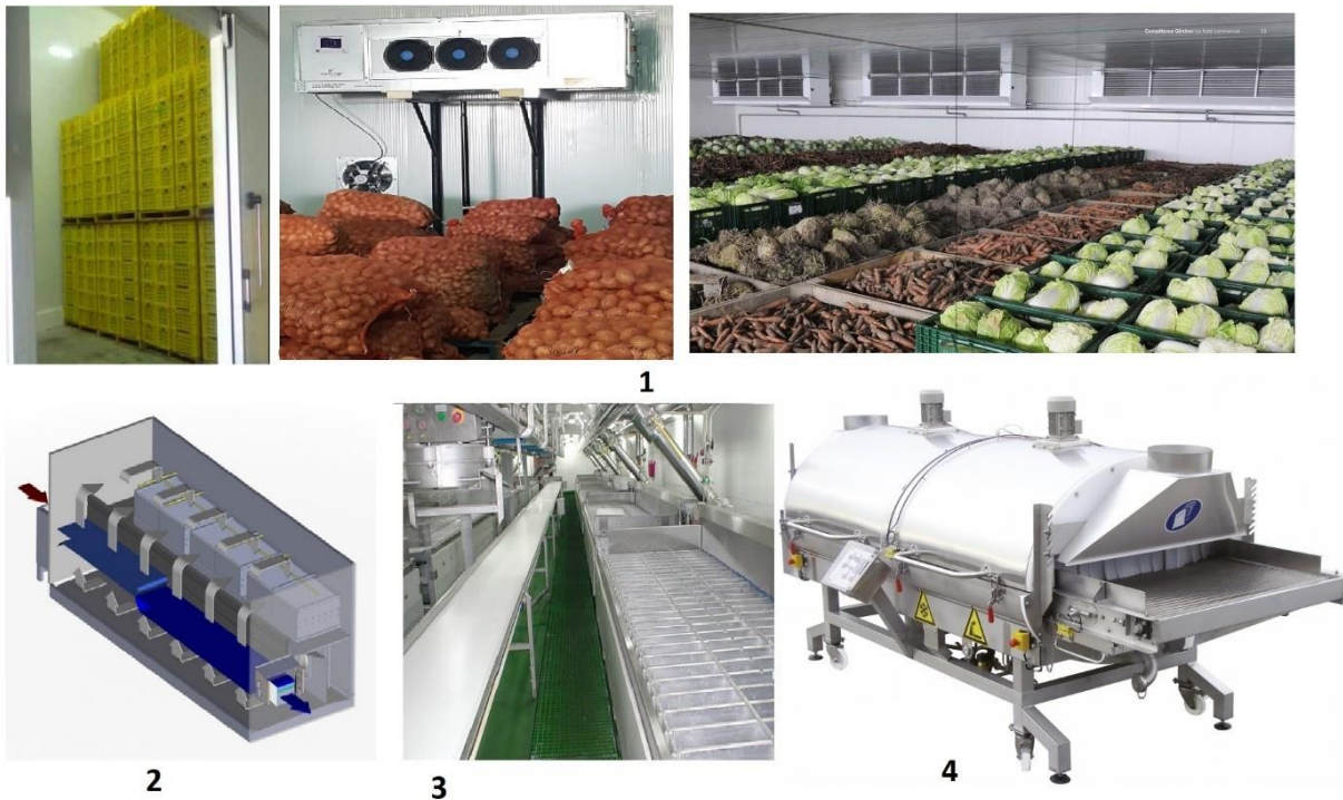
Chambres froides (1) Surgélateurs à lit fluidisé (2) Surgélateurs à plaques (3) Tunnel de surgélation (4)
