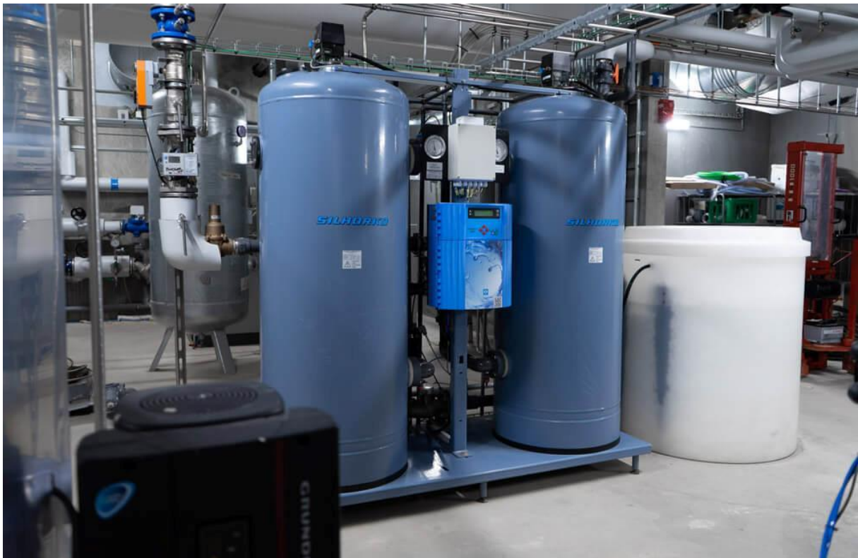
Figure : Système d'adoucissement : Deux adoucisseurs + Un réservoir de régénération de \text{NaCl} .
